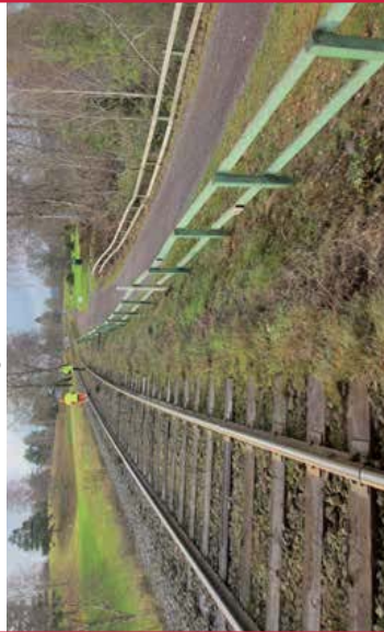
Bild 010 KM 7+445-560 Vågen behöver flyttas för att erhålla elsäkerhetsavstånd till spänningsförande anläggningsdel.
