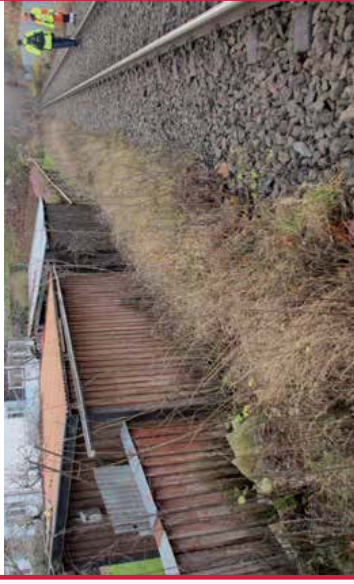
Bild 040 KM 10+060 Hus rivs alt. flyttas för att erhålla erforderligt 075 elsäkerhetsavstånd till spänningsförande anläggningsdel.
